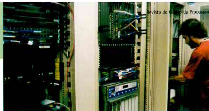
Técnico vistoria equipamentos de rede do CPD
