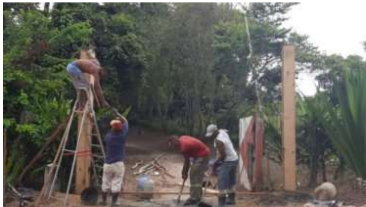
Fig.1 - Mutirão para construção do novo portão da Roça do Icimimó . Fonte: acervo Icimimó .
