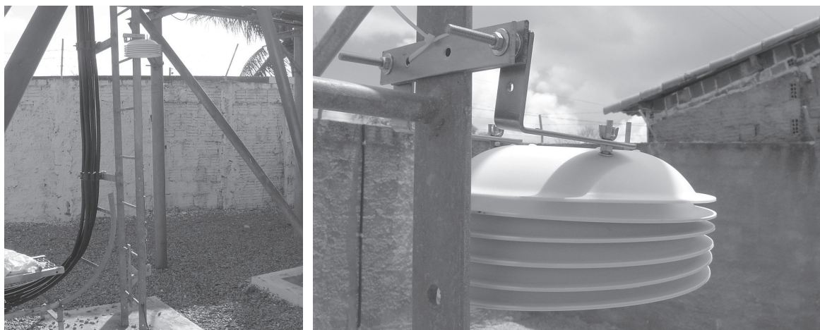
Figura 2 e 3 – Fotografias do equipamento instalado na escada e detalhe de fixação.
