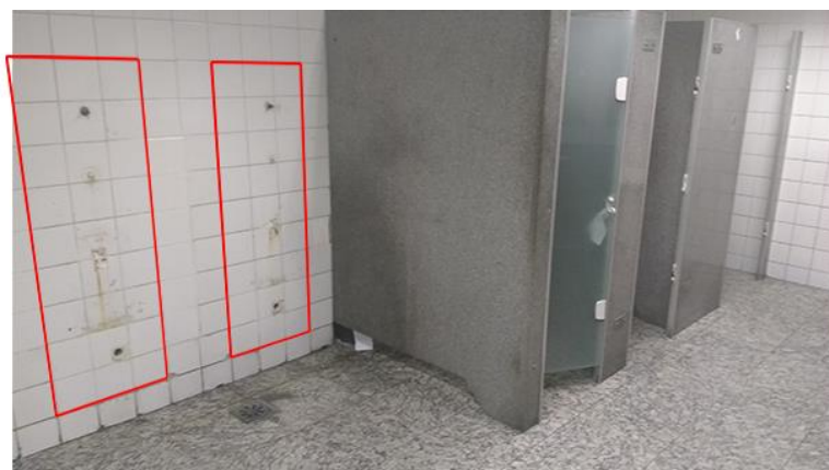
Figura 3 - Estação de metrô General Osório – Marcação em vermelho aplicada na fotografia para indicar onde foram retirados os mictórios (01/11/2015)
