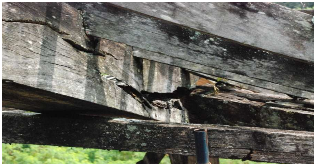
Detalhe de estrutura de madeira danificada, Itu-SP. 2016.
