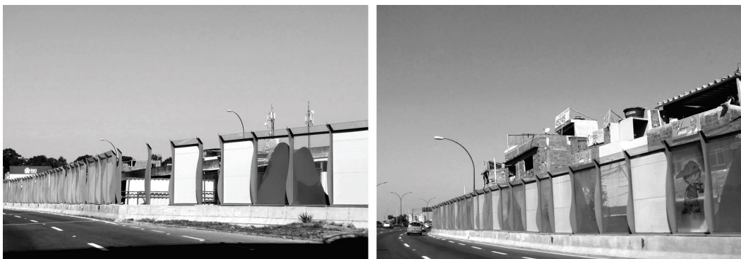
Figuras 3 e 4: Instalação da barreira “acústica” na Linha Vermelha, “escondendo” parte da Favela da Maré. Fotos do autor.
