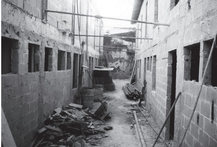
Foto 5 – Salvador, bairro de Santo Antônio - interior de lotes remembrados para abrigar empreendimento habitacional: obra convencional e projeto que preserva apenas as fachadas principais, ignora relações de ocupação e parcelamento típicas do conjunto tombado.
