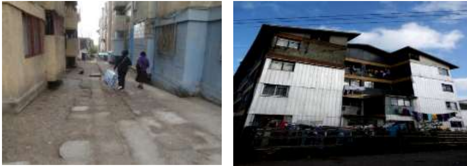
Imagen N°5: Población El Cobre I y II Antofagasta y Bloque 13 Hualpén, BíoBío. Condominios Sociales deteriorados.
