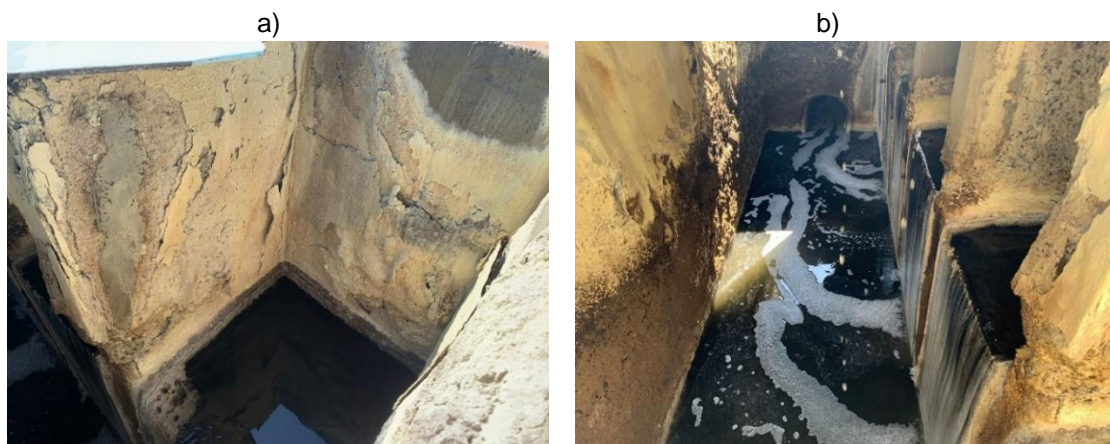
Figura 13: Caixa de passagem do efluente sanitário do Reator 1, sendo: a) vista superior; b) vista lateral.
