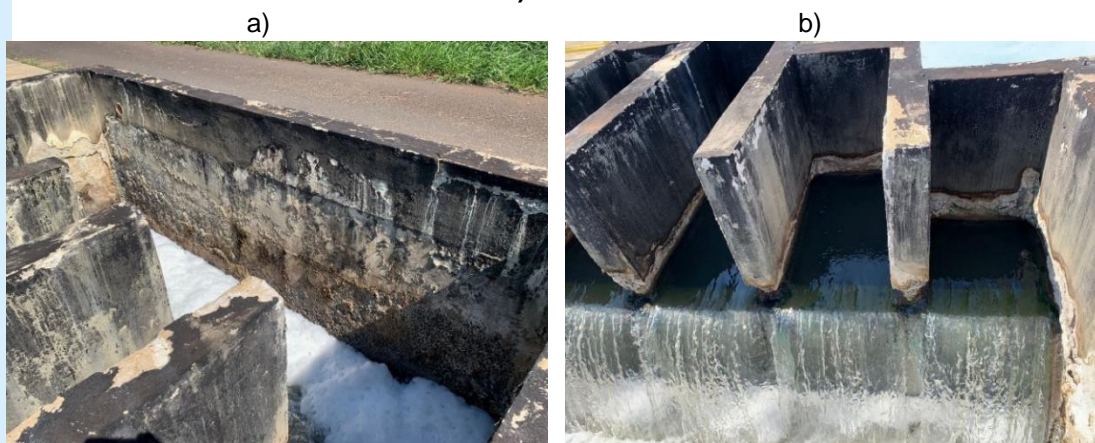
Figura 18: Caixa de passagem do efluente sanitário do Reator 6, sendo: a) vista superior; b) vista lateral.
