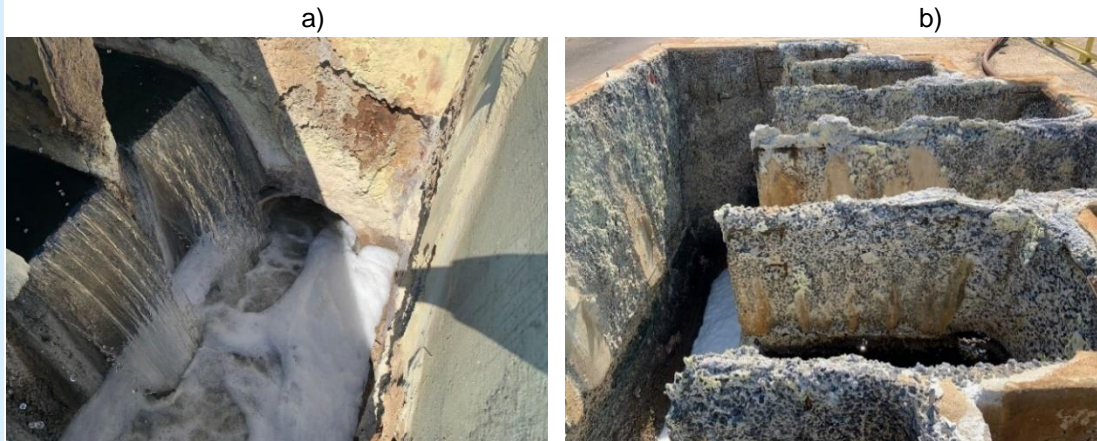
Figura 17: Caixa de passagem do efluente sanitário do Reator 5, sendo: a) vista superior; b) vista lateral.
