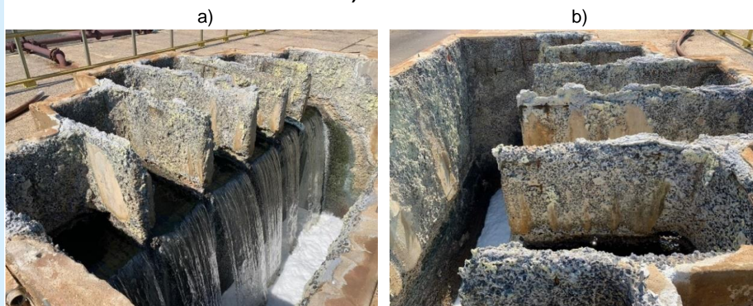
Figura 16: Caixa de passagem do efluente sanitário do Reator 4, sendo: a) vista superior; b) vista lateral.
