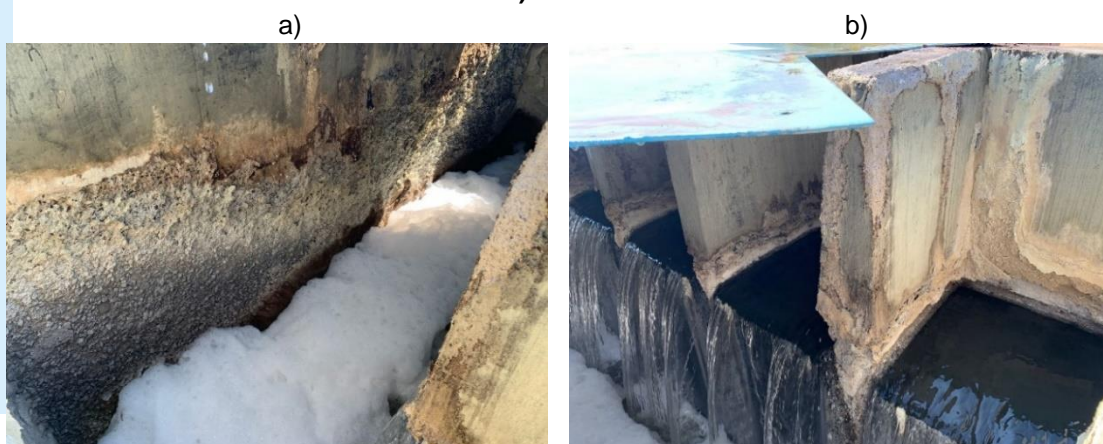
Figura 14: Caixa de passagem do efluente sanitário do Reator 2, sendo: a) vista superior; b) vista lateral.
