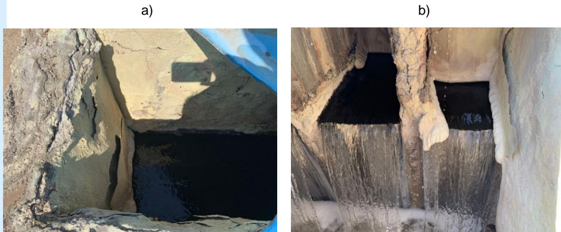
Figura 15: Caixa de passagem do efluente sanitário do Reator 3, sendo: a) vista superior; b) vista lateral.
